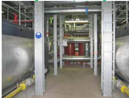
Co-génération copeaux de bois et gaz naturel, Fribourg
